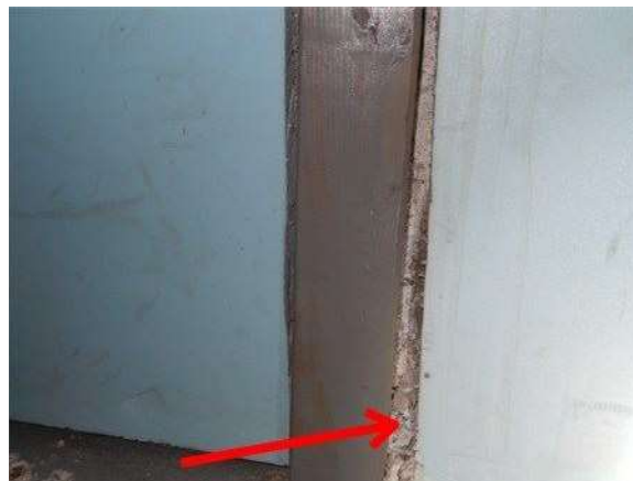
Des signes d'efflorescence étaient visibles au sous-sol à l'endroit correspondant à la fissure du côté gauche de la maison.
