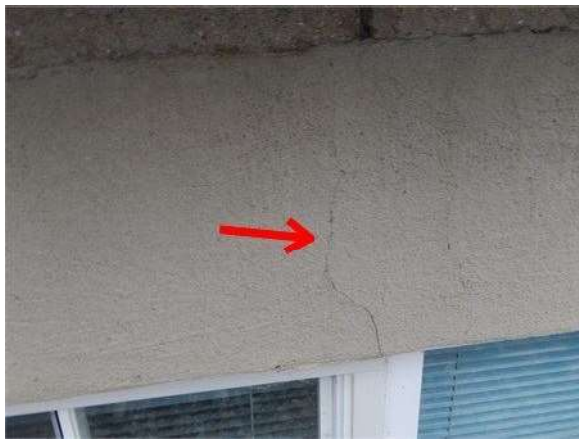
Fissure au dessus de la fenêtre à l'avant de la maison.
