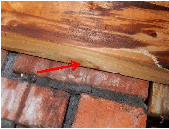
La structure de bois autour du foyer était mouillée.
