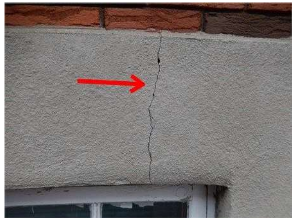
Fissure au dessus de la fenêtre située du côté de l'entrée asphaltée.
