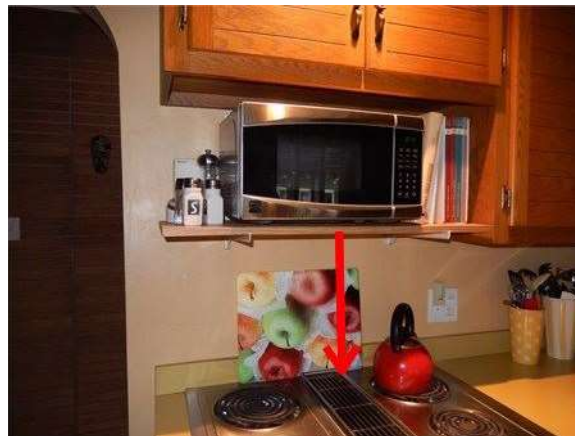
La distance entre la cuisinière et l'étagère n'est pas réglementaire et comporte des risques d'incendie (minimum de 750 mm.)
