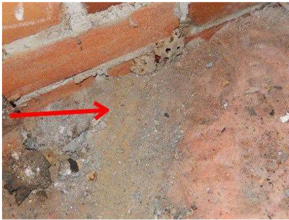
L'isolant autour du foyer était mouillé.
