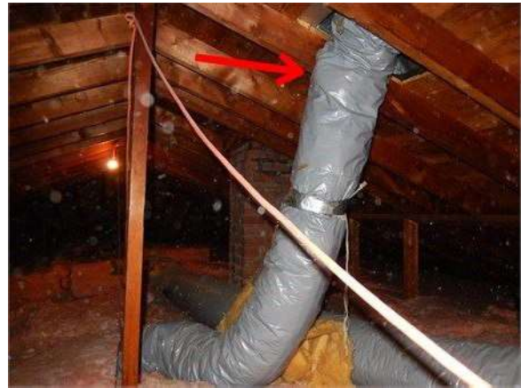
Le registre est branché directement dans le maximum.
