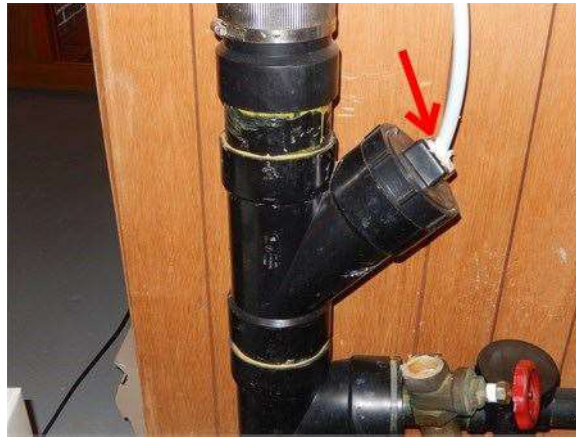
Le tuyau de condensat s'évacue dans le couvercle du regard de nettoyage.
