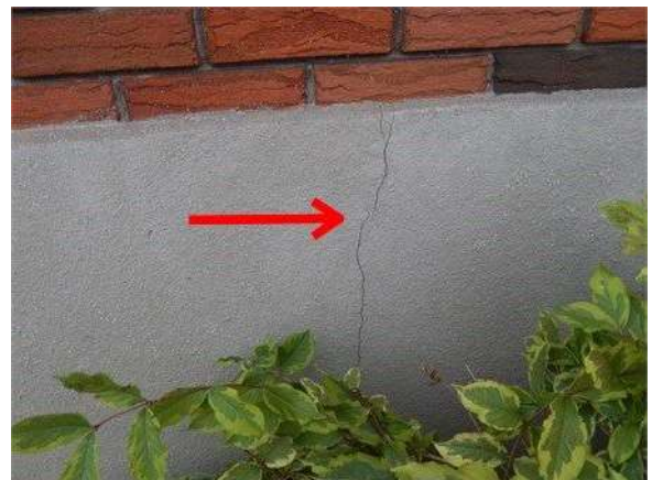
Fissure à l'arrière près de la galerie.
