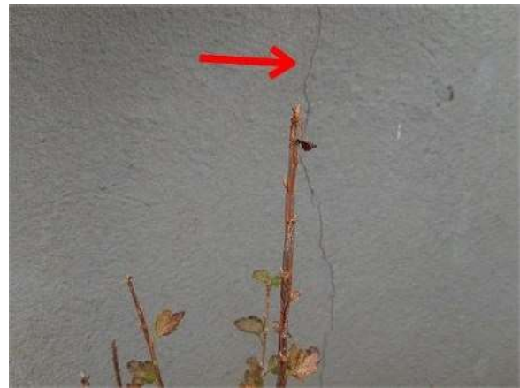
Fissure près du balcon avant à l'avant de la maison.
