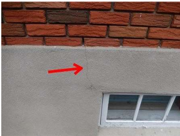
Fissure dans le coin supérieur gauche de la fenêtre située sur la côté de l'entrée asphaltée.
