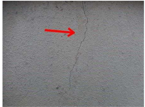
Fissure dans le coin droit avant.
