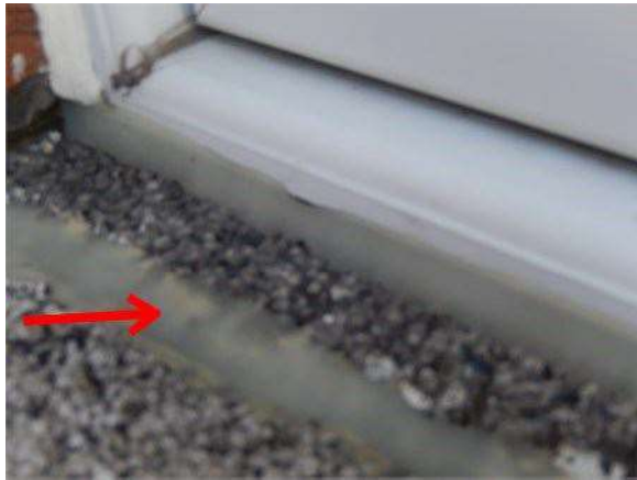
L'allège dans le coin de la fenêtre du salon est fissurée.
