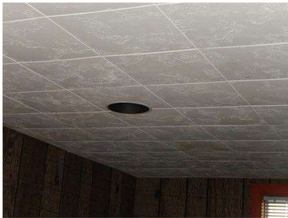
Tuiles dans le plafond du sous-sol.
