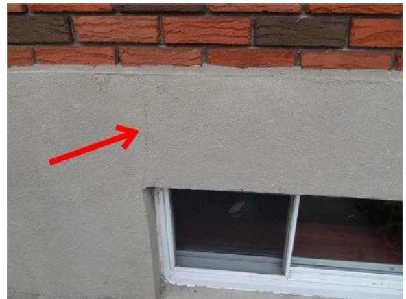
Fissure dans le coin droit au dessus de la fenêtre derrière la maison.
