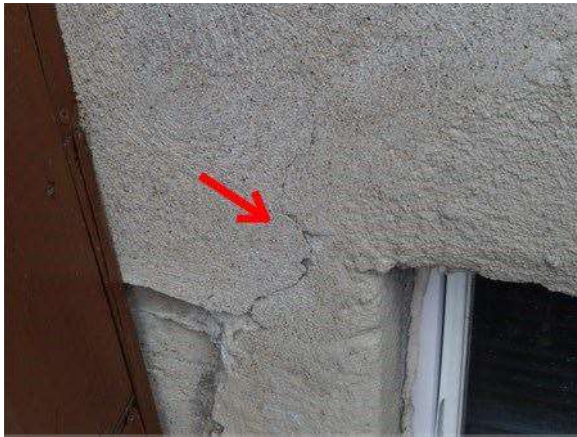
Fissure dans le crépi sur le mur arrière de la maison près de la galerie.
