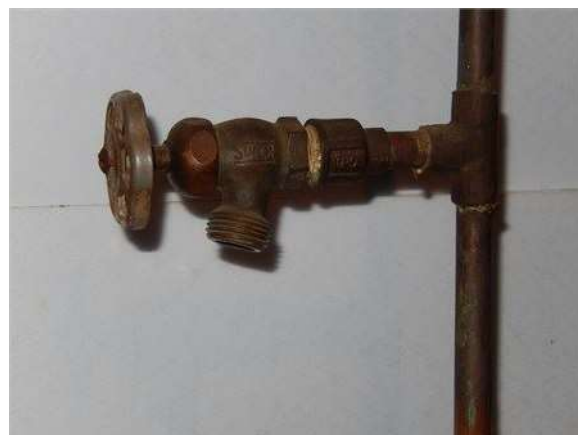
Une valve de purge était localisés au-dessus de la valve d'arrêt.
