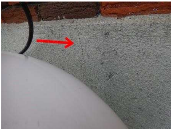
Fissure derrière la bonbonne de propane.
